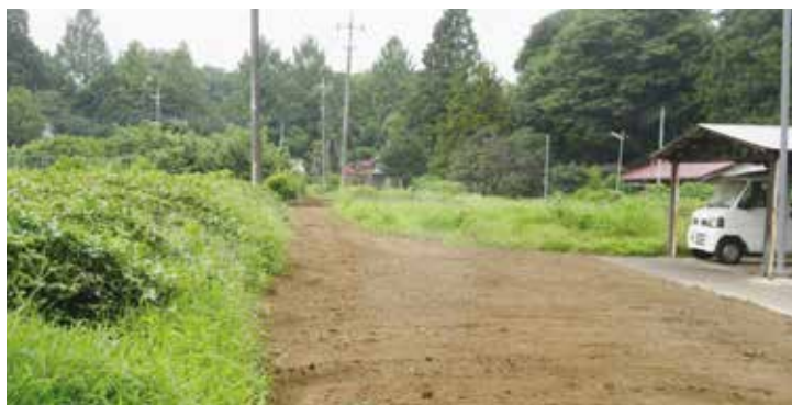
7月太陽光パネルが設置されていた土地の前面にある私道の舗装を撤去し農地に復元
